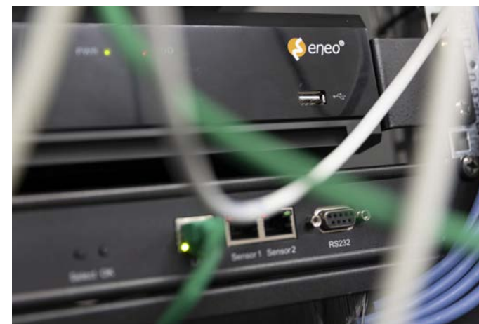
Le NVR est installé dans le local serveur du studio
