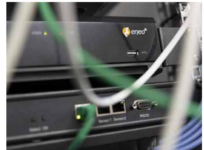
Im Serverraum des Studios ist der NVR untergebracht
