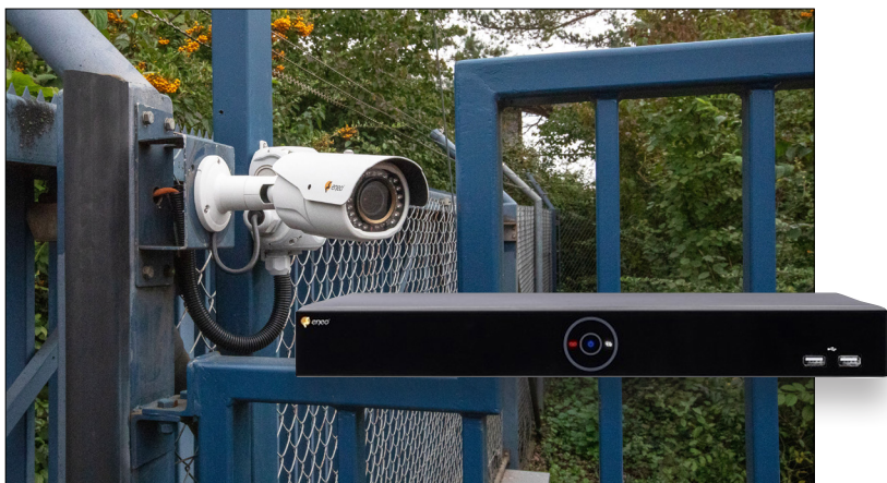
Les enregistrements vidéo des zones surveillées sont stockés à court terme.
