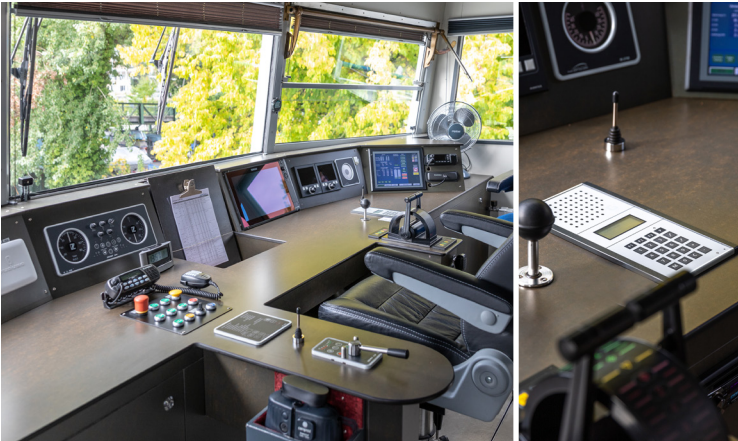
Im Steuerhaus (Oberdeck) ist die Sprechstelle direkt in die Armatur eingelassen.
