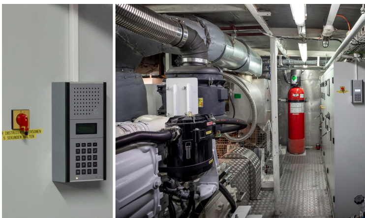
Dans la salle des machines, une station intercom sert de portevoix moderne pour communiquer avec le pont.
