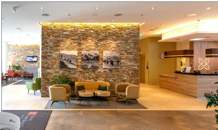
10 caméras ont été installées rien que dans l'entrée, le lobby et près des ascenseurs.
